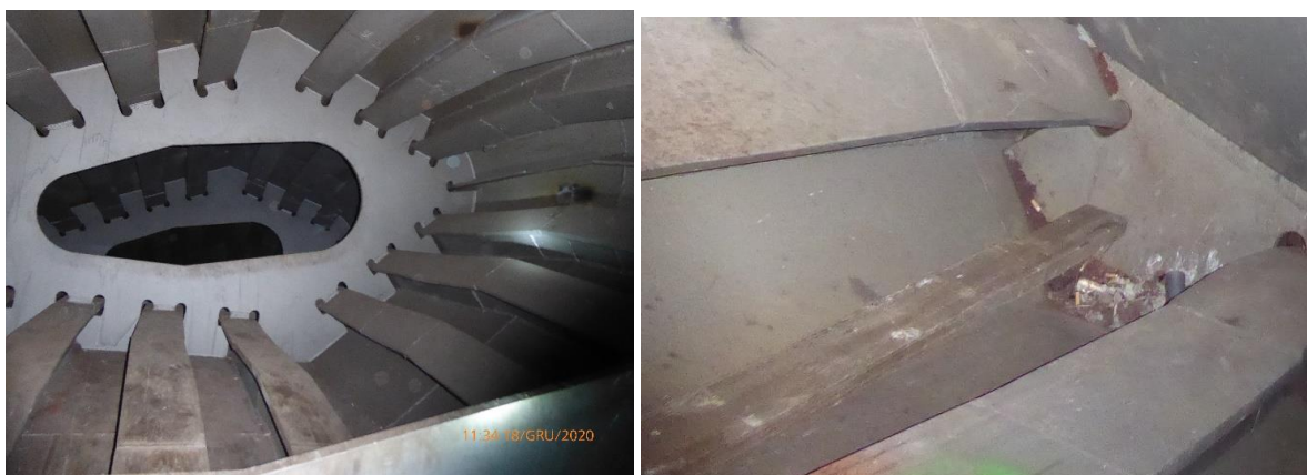
Rys. 9.1. Konstrukcja płaszczu pylonu z widocznymi obszarami z nalotem korozyjnym (wybrany przykład)
