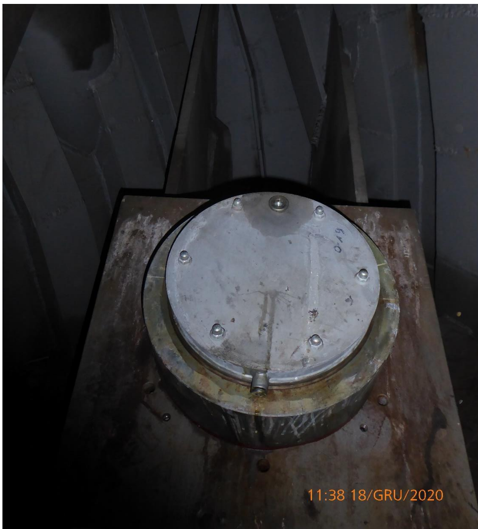
Rys. 9.2. Konstrukcje zakotwień want. Widoczne drobne nacieki korozyjne na blachach i spoinach.
