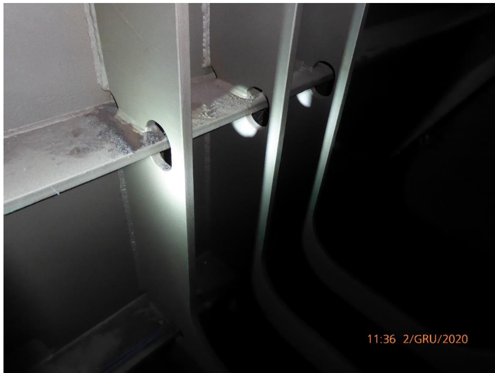
Rys. 8.1. Konstrukcja wewnątrz skrzynek mostu. Widoczne drobne naloty korozyjne.
