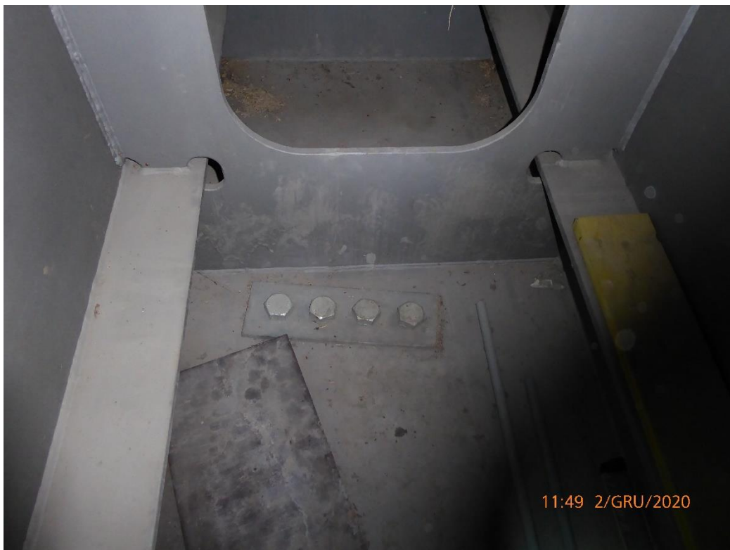
Rys. 8.3. Konstrukcja wewnątrz skrzynek mostu. Widoczne drobne naloty korozyjne
