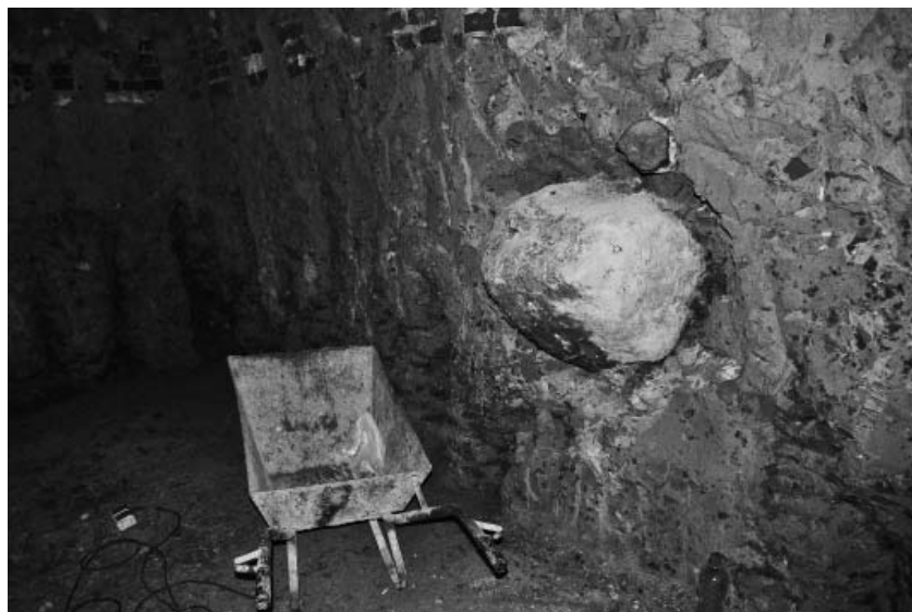
Fot. 1. Występowanie głazów narzutowych oraz pozostałości starych fundamentów może być przyczyną utrudnień podczas prowadzenia prac. Na zdjęciu widoczny jest glaz, który wszedł w strukturę podbicia fundamentu wykonywanego w technologii iniekcji strumieniowej jet-grouting (fot. K. Wanik)
