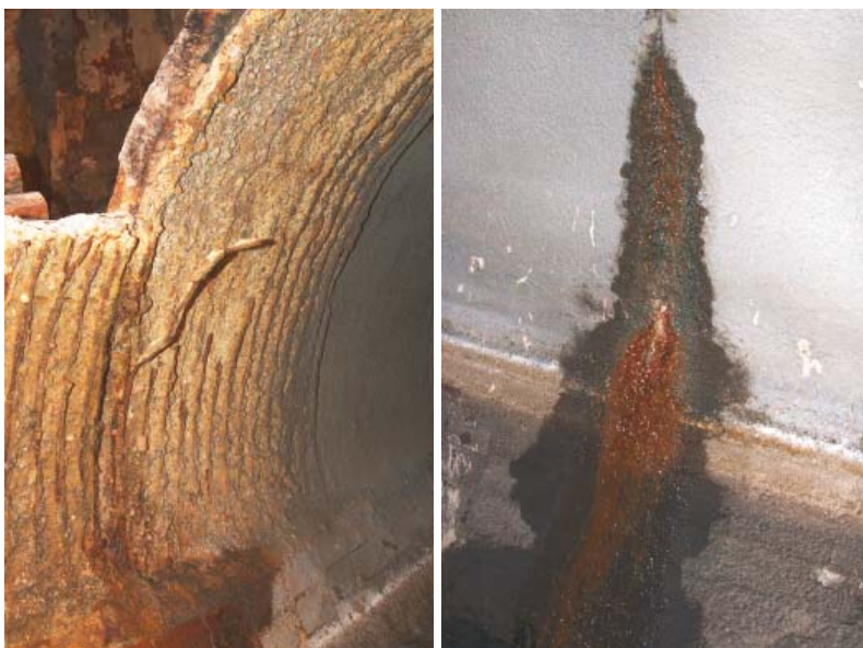
Fot. 1. Brak otuliny i korozja zbrojenia naprawianego odcinka oraz przecieki połączeń
