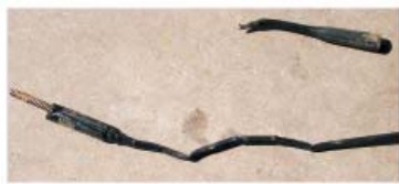
Rys. 13. | Wadliwa instalacja z powodu niskiej jakości materiału
